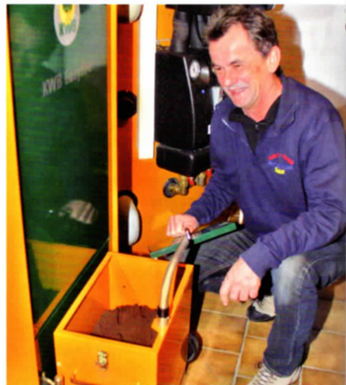
Zu den routinemäßigen Wartungsarbeiten gehört das Leeren des Aschekoffers, der hier von Manfred Müller auf sein Füllvolumen hin kontrolliert wird
