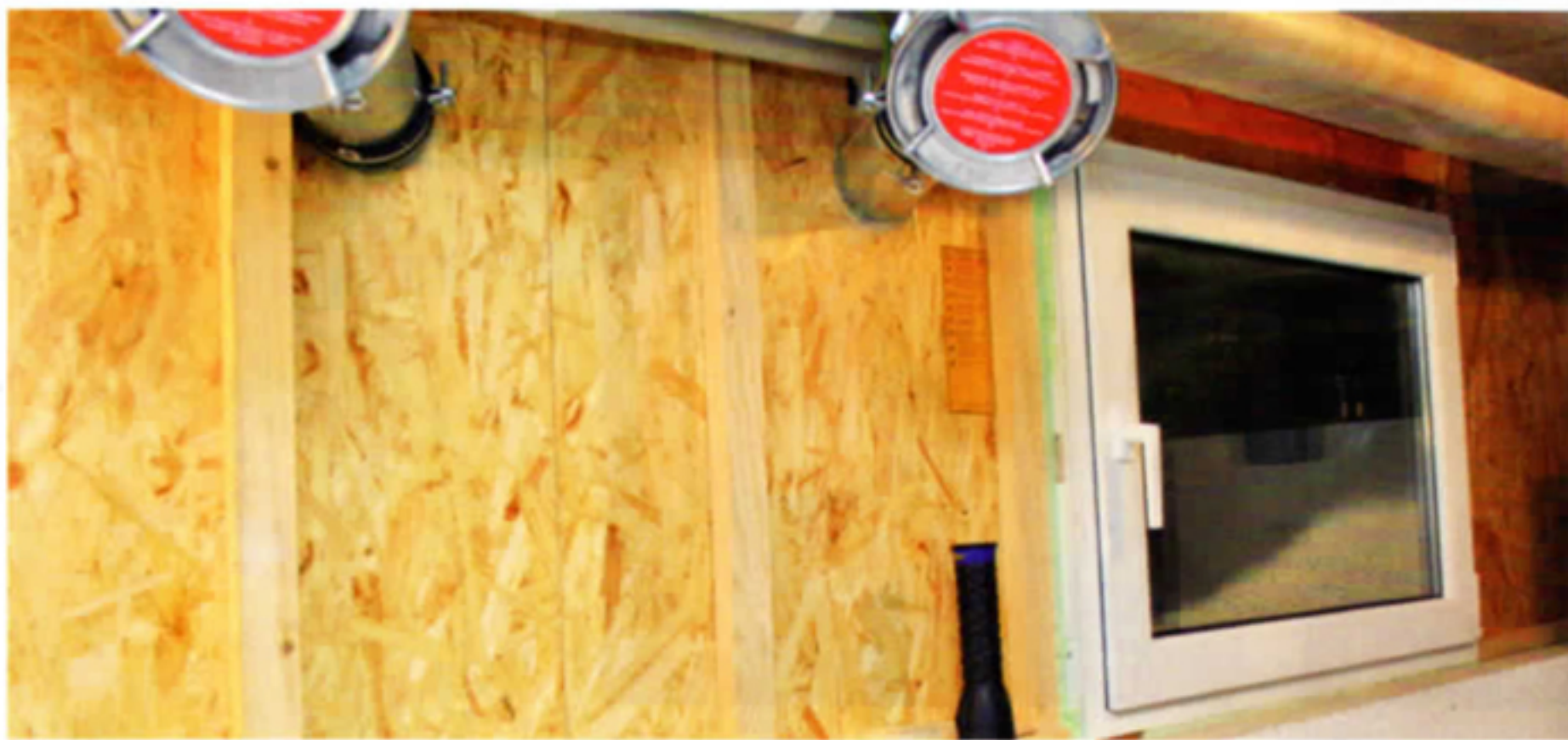
Dank des Fensters können sich die Hausbesitzer jederzeit ein Bild vom aktuellen Füllstand des Pelletsbunkers machen
